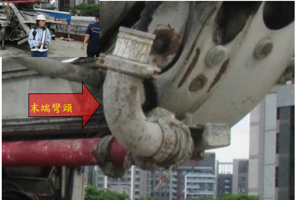
附照4-房○榮稱述太空包固定於混凝土泵浦車壓送管末端彎頭吊運(未發現彎頭斷裂)
