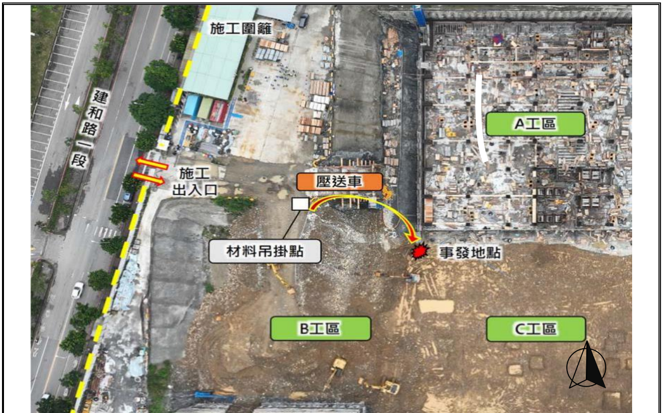
附照1-災害發生於工址C區（臺中市北屯區太原路3段與建和路1段口）
