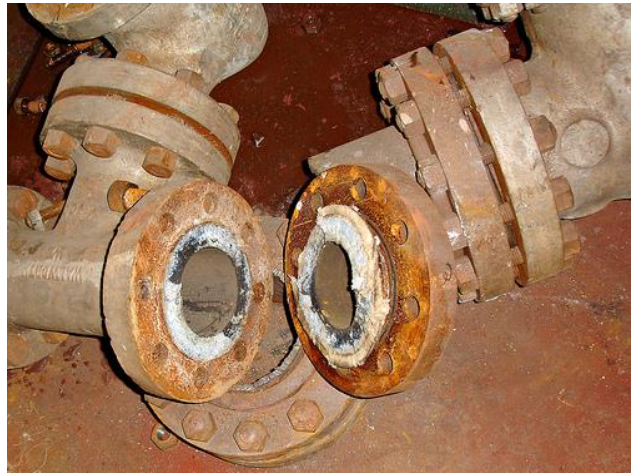
(墊片已劣化破損)
