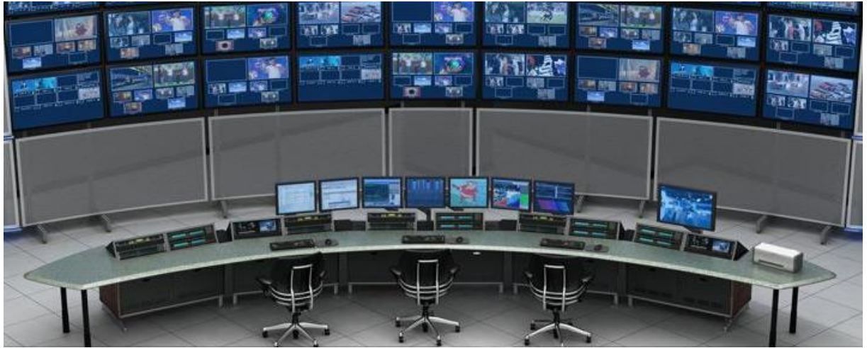
(某石化工廠之控制室)
