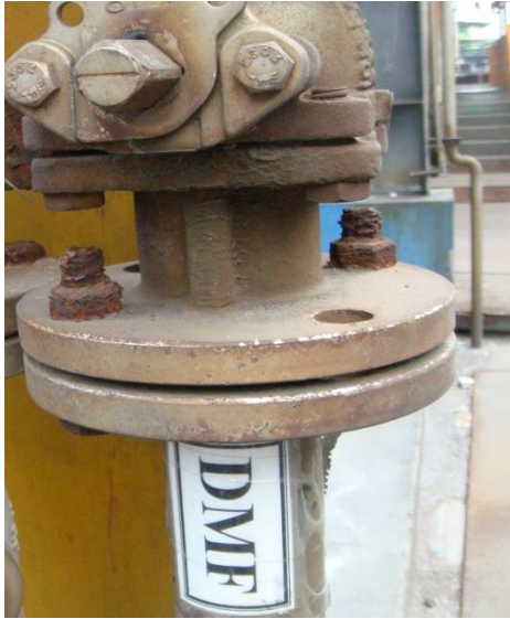
(二甲基甲醯胺 DMF 管線 法蘭接合處螺栓未妥善 固定，且材質不符)
