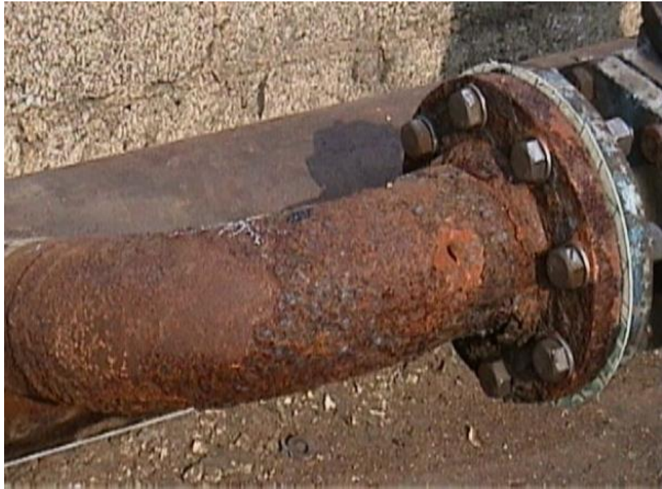
(管線之不同材質接合處其電位較低者加速腐蝕後洩漏)
