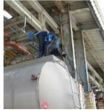
裝卸料站防止墜落裝置
