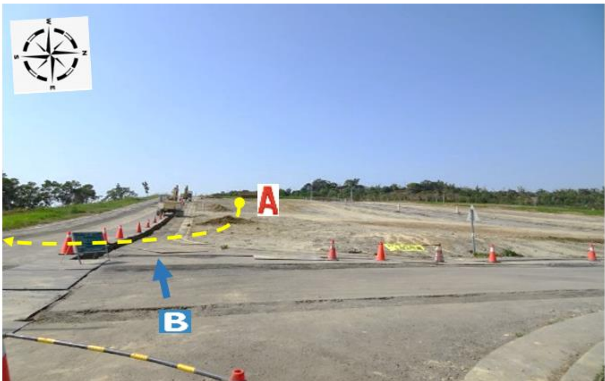
說明 3 | 109 年 11 月 3 日事故現場照片。照片中黃色虛線為車輛滑落路徑，A 點為事故車輛停車位置，B 處為管溝開挖處，黃色虛線為車輛滑落路徑。
